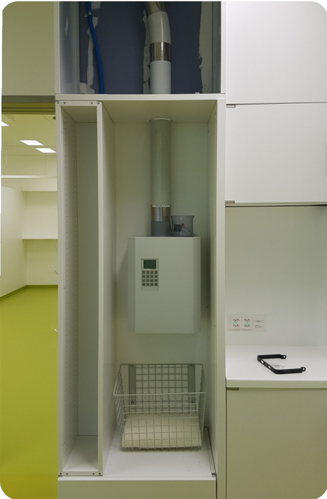
Metallschrank mit integrierter Rohrpostanlage
